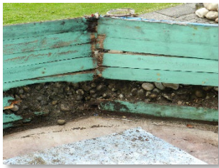
Ein durch Feuchtigkeit im Erdreich verfaultes Holzbecken
